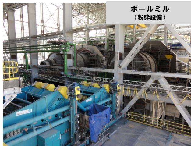
SAG (Semi-Autogenous Grinding) ミル (粉碎設備)
